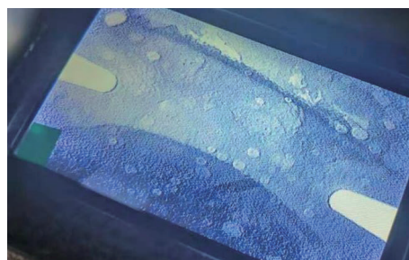
图4 不合格桩(120号桩)水下摄像
